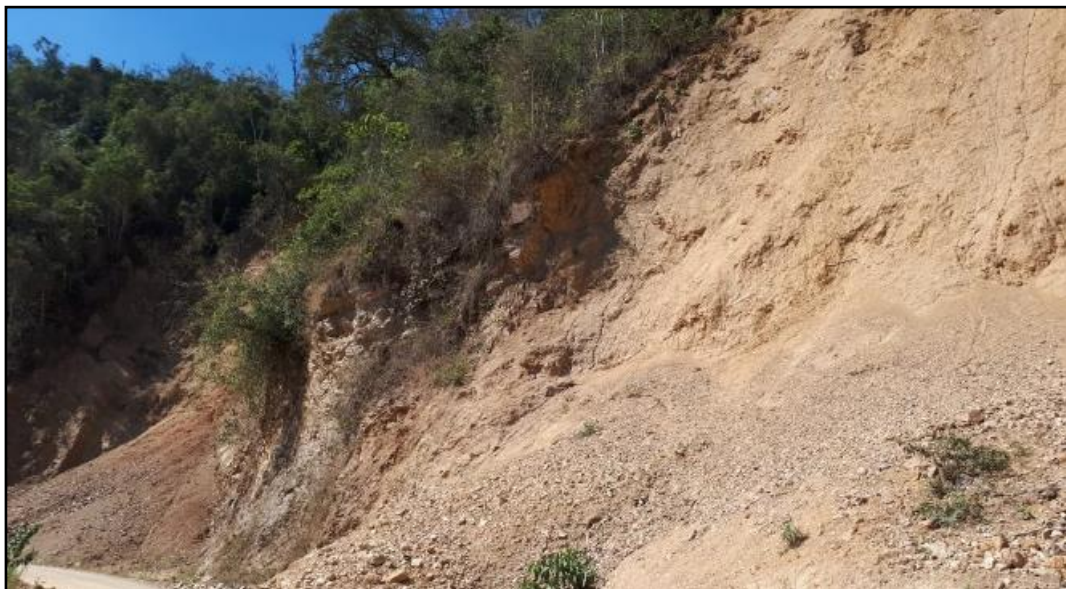
Figura 22 Deslizamiento en la vía Capiro - Conchicola
