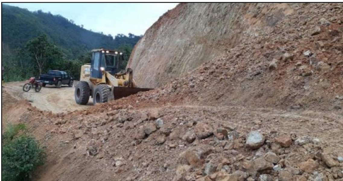
Figura 4 Deslizamiento en el Sitio Guayacán
